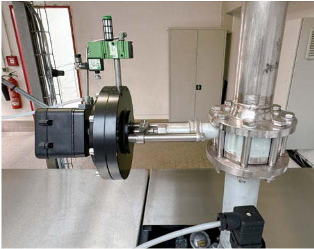
Das eingesetzte Gleitschieberventil in DN80 (15 kg) ist kompakter und leichter als jedes der beiden zuvor installierten Sitzkegelventile (zusammen ca. 170 kg).
