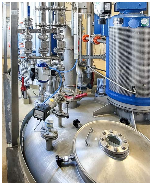
Ein Gleitschieberventil Typ 8043 von Schubert & Salzer regelt den Durchfluss von flüssigem und gasförmigem Schwefeldioxid in den Reaktionsbehälter.
