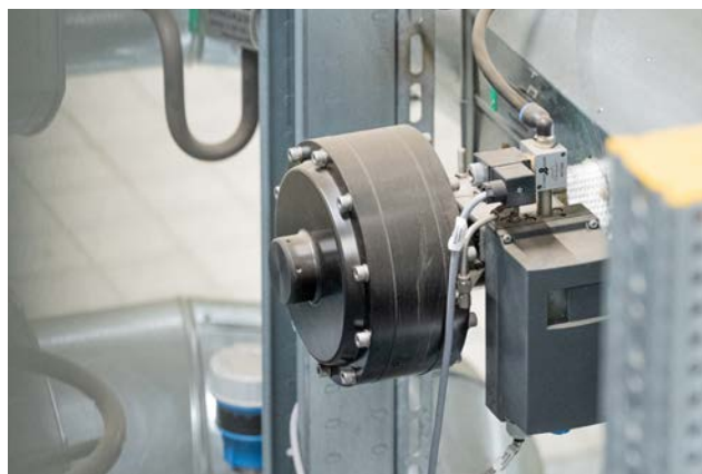
Im Primärvorlauf werden insgesamt sechs Gleitschieberventile zur Mengenregelung des Volumenstroms eingesetzt.
