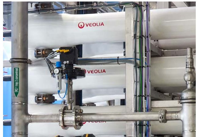
In jeder der zwölf Umkehrosmose-Einheiten kommen zur Druckregelung je ein DN125- und ein DN50-Gleitschieberventil zum Einsatz.
