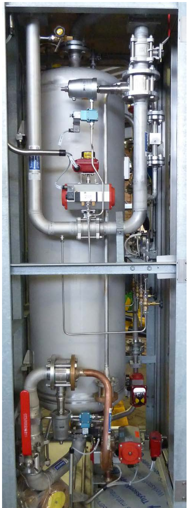
Einblick ins Innere einer SIP-Box: Zwei Gleitschieberventile vom Typ 8040 wurden im Laufe der Jahre so weiterentwickelt, dass sie in der Lage sind die benötigten Impulse mit starken Stoßwellen freizusetzen und eine Mindest-Standzeit von einem Jahr, also mehreren Millionen Schaltungen, aufweisen.
