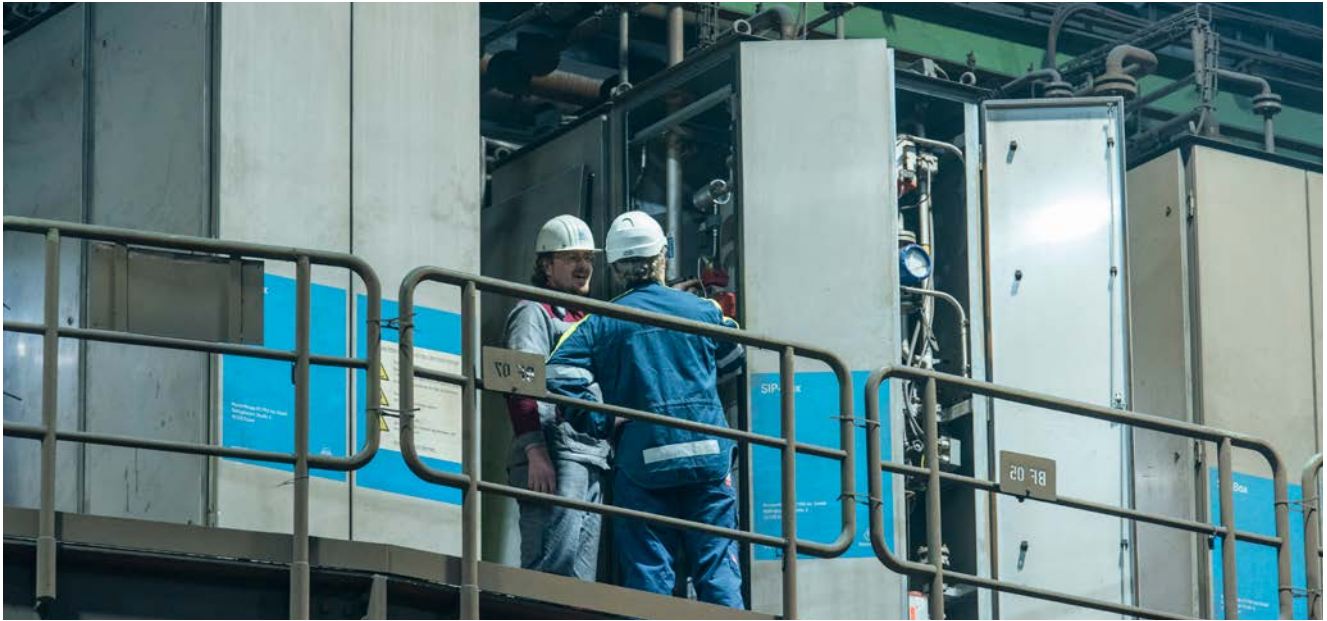
Die SIP-Boxen sind das Ergebnis jahrelanger Forschung und Entwicklung: Von den ersten Versuchen am Institut für Eisenhüttenkunde der RWTH Aachen, über den Aufbau und die Optimierung eines Prototypen am Hochofen Schwelgern bis zur Errichtung der vollständigen SIP-Anlage während des laufenden Betriebs.
