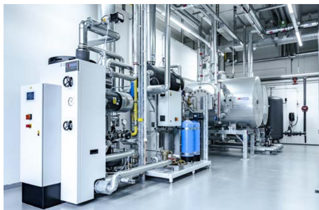
Un générateur de vapeur rapide Junior 400 TC de CERTUSS alimente le banc d'essai à vapeur dans la centrale énergétique de Schubert & Salzer.
