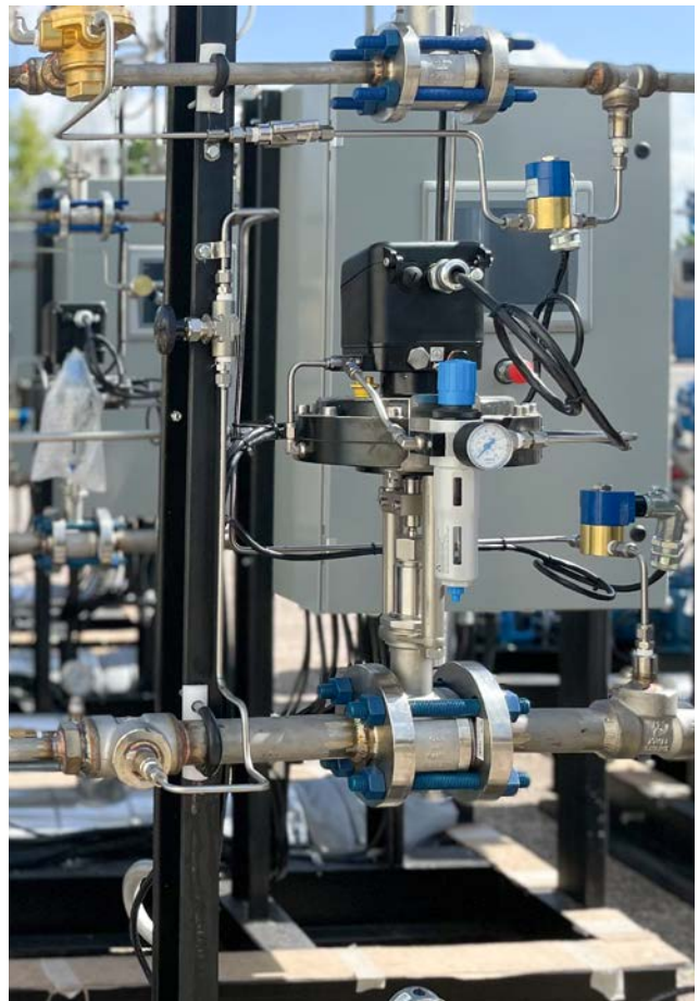
Figure 02 : grâce au rapport de réglage élevé de la vanne à glissière, le TWG ne nécessite plus qu'une vanne pour le gaz et une pour l'air.
